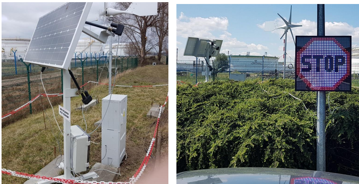
Rys. 62. Prototypowa instalacja systemu zasilania inteligentnego znaku.
