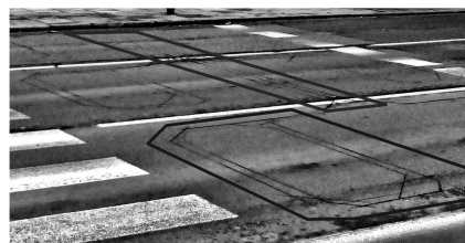
Rys. 1. Pętle indukcyjne połączone wspólnym przyłączem do skrzynki z analizatorem
