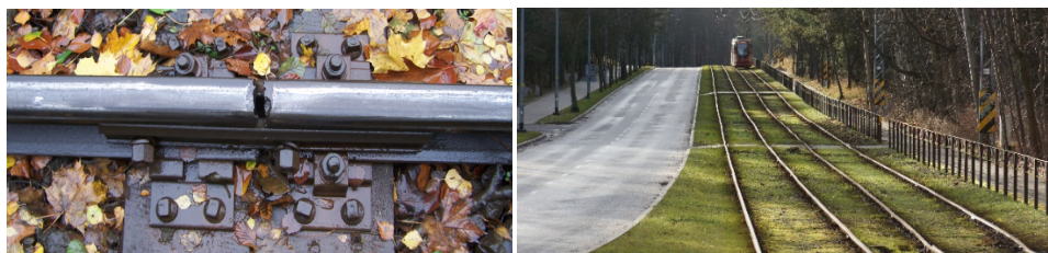
Rys. 4. Przykłady krytycznego i bardzo złego stanu technicznego torów tramwajowych
