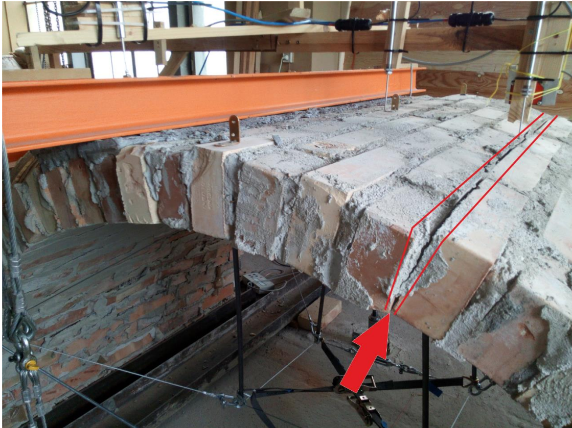
Rys. 81 Badane sklepienie ze wzmocnieniem, obciążenie 2x400kg, widoczne pęknięcie.
