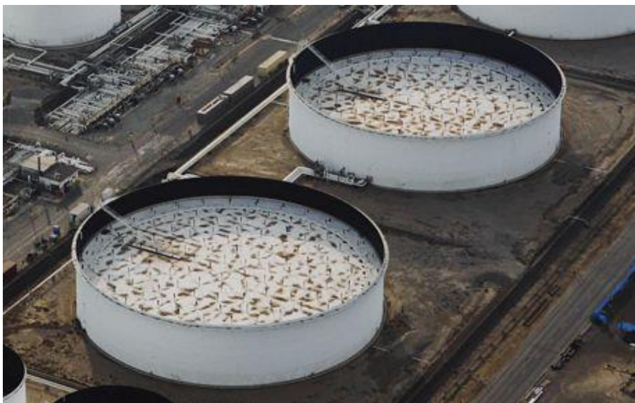
Rys. 2.3. Zbiorniki z dachami pływającymi znajdujące się w Chalmette, Luizjana, USA ( http://www.hazmatnation.com )
