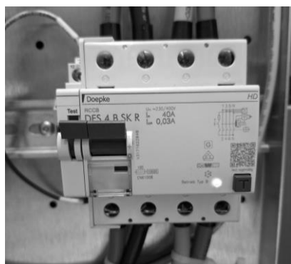
Rys. 2. Wyłącznik różnicowoprądowy o I_{\Delta n} = 30 mA typu B zainstalowany w stacji ładowania pojazdów elektrycznych (fotografia udostępniona przez firmę GreenWay Polska Sp. z o.o.)
