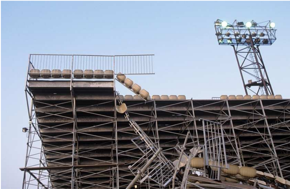
Fot. 1.4 Awaria tymczasowej konstrukcji trybuny na Korsycy w 1992 roku ( http://www.stadiumguide.com ).
