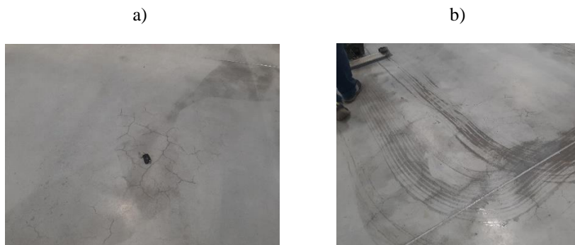
Rys. 7. Widok odspojenia warstwy z suchej posypki utwardzającej DST od podkładu betonowego ( fol. S. Świątek-Żołyńska )
