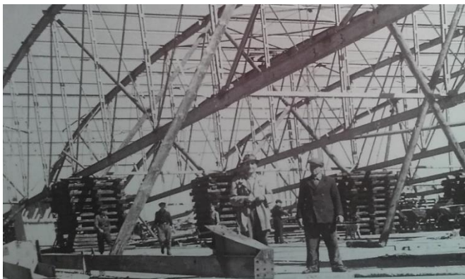
Il. 3.05. Zdjęcie wykonane w trakcie wznoszenie konstrukcji dachu dawnego hangaru lotowskiego, dzisiejszej Galerii Zaspa. Źródło: Fotopolska, https://fotopolska.eu/Gdansk/b51274,Lotnisko_Gdansk-Wrzeszcz,24,48.html?f=963885-foto [dostęp: 12.11.2021].
