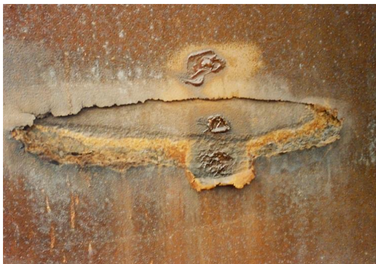
Rys. 1.8. Rozwarstwienie blachy od strony wewnętrznej płaszcza zbiornika walcowego o osi pionowej ( V = 10000 \text{ m}^3 )
