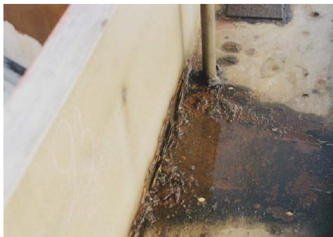
Rys. 1.24. Korozja górnego pierścienia płaszczu zbiornika z dachem pływającym w miejscu lokalnego wklęśnięcia w pierścieniu wiatrowym (podeście dla personelu) [12]
