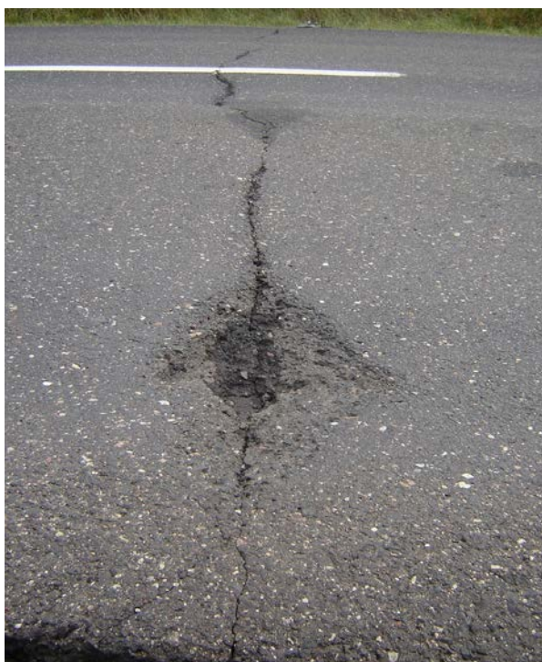
Rys. 3. Przykład postępującego zniszczenia konstrukcji nawierzchni po powstaniu spękania niskotemperaturowego
