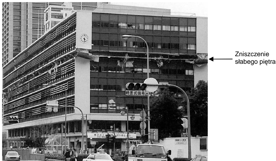
Fot. 1. Zniszczenie słabego piętra na poziomie środkowej kondygnacji (Kobe 1995) Photo 1. Soft-storey failure of the intermediate storey (Kobe 1995)
