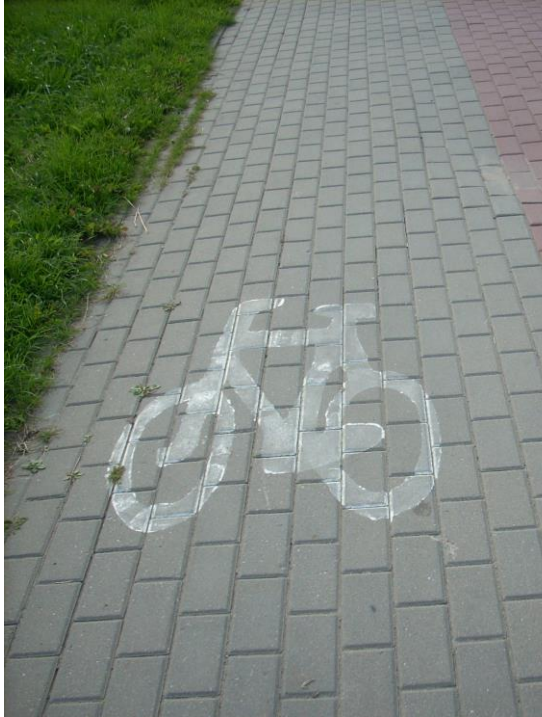
Fot.9. Zamienione kolory ścieżki rowerowej i ciągu pieszego na ul. Myśliwskiej.
