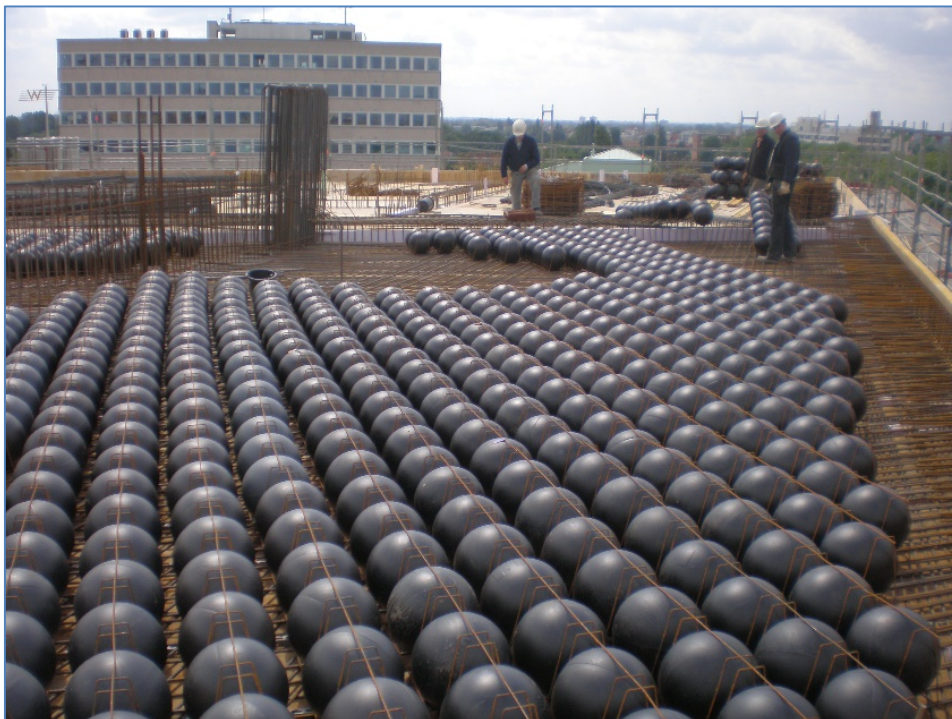
Abb. 1: Eingebaute cobiax-Hohlkörpermodule, System cobiax Eco-Line vor Einbau der oberen Bewehrung und Betonage (Neubau eines Bürogebäudes in Bremen)
