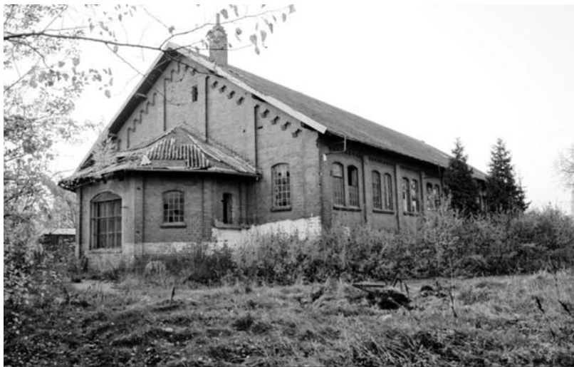
Fot. 1. Garnizon w Gdańsku Wrzeszczu – budynek dawnej ujeżdżalni koni, stan z 2008 r.
