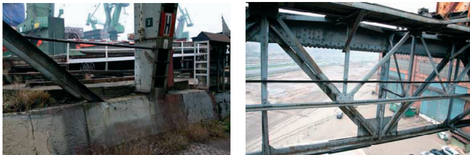
Rys. 3. Typowe stwierdzone uszkodzenia konstrukcji
