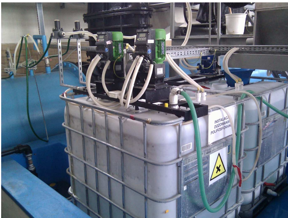
Rys. 25. Instalacja dozowania inhibitora korozji do wody sieci wodociągowej miasta Gdańsk.
