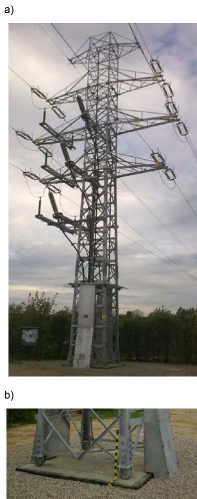
Rys.6. Widok: a) kompletnego słupa kablowego, b) powierzchni gruntu w bezpośrednim sąsiedztwie słupa
