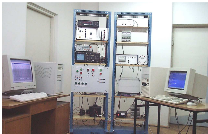
Rys. 1. Widok stanowiska badawczego do prowadzenia diagnostyki synchronizatorów prądu
