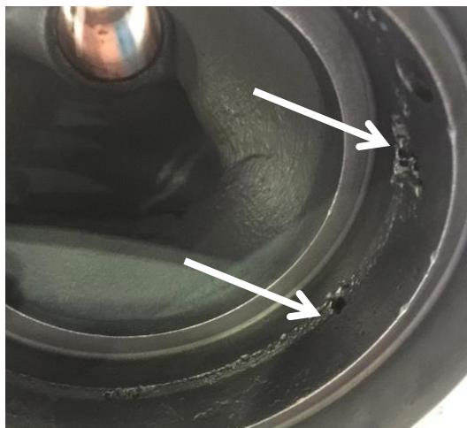
Rys. 2. Zużyte gniazdo zaworu wylotowego silnika okrętowego- widoczne ślady perforacji
