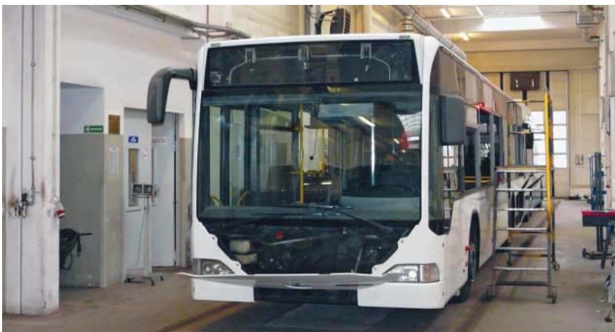
Fot. 09.jpg: Nadwozie autobusu Mercedes Benz O530 w trakcie prac dostosowawczych w procesie konwersji na trolejbus, Gdynia, zajezdnia trolejbusowa na Grabówku, 24.03.2011 r.
