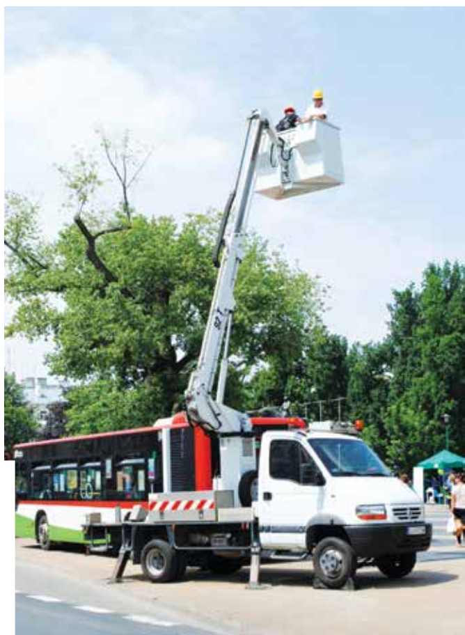
Fot. 21. Iveco należące do MPK w Lublinie wyposażone w podnośnik koszowy na ramieniu do prac sieciowych. Fot. M. Żyśko
