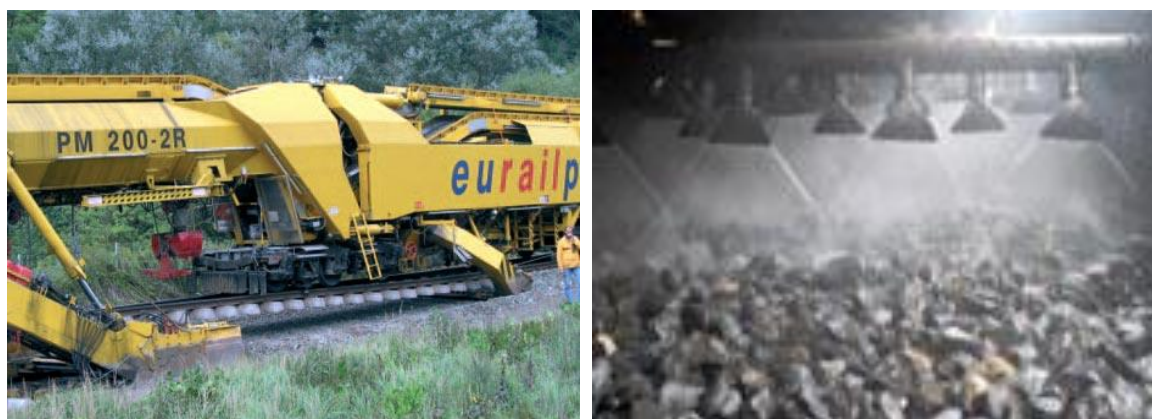
Rys. 9. Widok maszyny PM 200-2R do wymiany nawierzchni (z lewej). Widok płuczki ciśnieniowej czyszczącej podsypkę (z prawej) [2]
