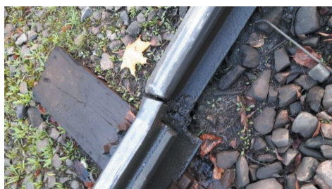
Fot. 1. Złamanie szyny w miejscu styku przejściowego pomiędzy szyną S49 oraz 60RiN Źródło: materiały własne
