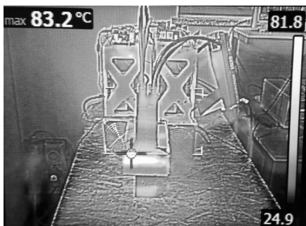
Rys. 6. Pomiar temperatury (kamerą termowizyjną) izolowanej celki przekształtnikowej obciążonej mocą 34 kW Na pierwszym planie transformator
