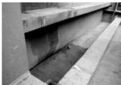
Fot. 1. Plastikne wyboczenie środników stalowej skrzynki mostu podczas nasuwania Photo 1. Plastic buckling of web of steel girder during launching
