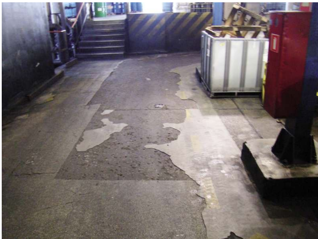
FOT. 4. Uszkodzenia posadzki betonowej w hali konfekcjonowania olejów i produktów ropopochodnych, w której poruszały się ciężkie wózki widłowe; fot. arch. autorów
