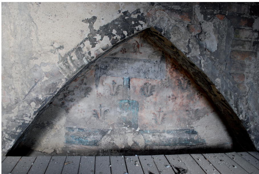
Il. 2. Górny fragment Ukrzyżowania w centralnej blendzie na fasadzie kościoła, stan z 2013 r. Fot. P. Samól
