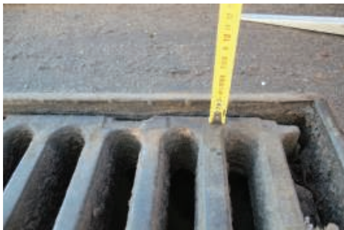
3. Przykład niewłaściwego spasowania elementów żeliwnych stwierdzony na ulicy Wyzwolenia w Gdańsku
