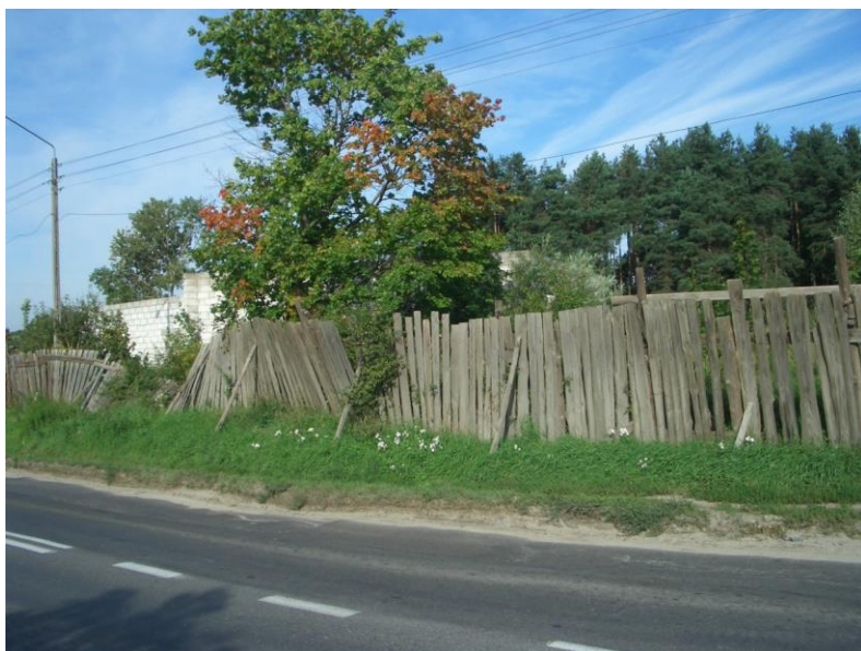
Fot 1. Ogrodzenie terenu porzuconej budowy od 10 lat przy ulicy Świętokrzyskiej w dzielnicy Gdańsk - Łostowice. Fot. B. Kotarska-Lewandowska 2010.
