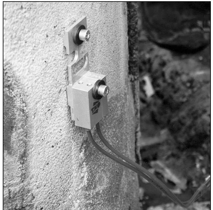
Rys. 1 Czujnik zamontowany na głowicy pala
