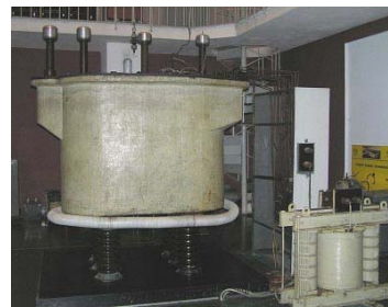
Rys. 7. Transformator TPZ 160 kV 300 kVA przerobiony z niemieckiego transformatora 200 kV z TH Breslau wykorzystywany w latach 1962-2014 [5]
