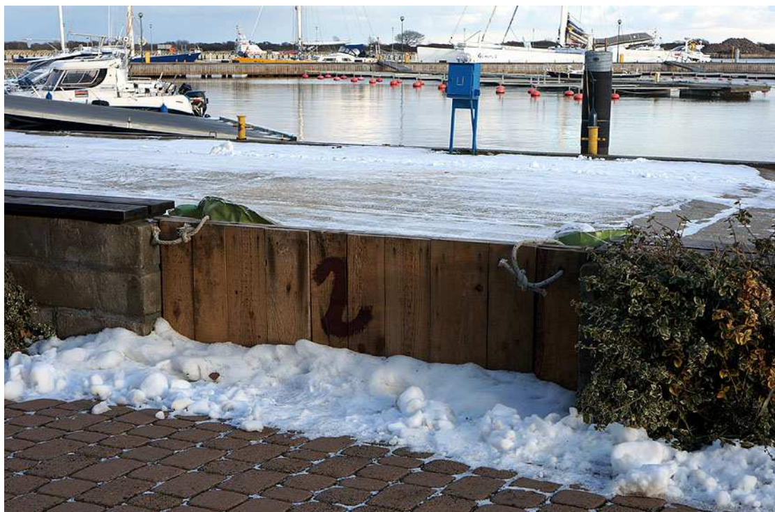
Fot. 2. COSA AZS w Gdańsku-Górkach Zachodnich. Murki betonowe i „wrota” przeciwpowodziowe umocnione workami z piaskiem oddzielające taras restauracji od nabrzeża. Fot. Katarzyna Rembarz (17.01.2016)
