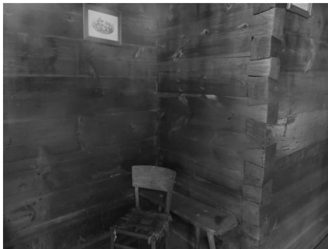
Rysunek 5. Brak pokrycia i wykończenia ścian we wnętrzu cerkwi w Chotyłubiu.
