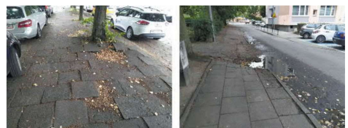
Fot. 12. Zły stan techniczny chodnika (fotografie – zasoby własne autorek)
