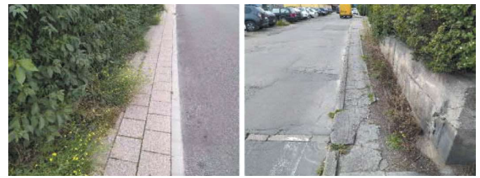
Fot. 10. Roślinność zabierająca przestrzeń chodnika oraz zły stan techniczny chodnika na ulicy Lęborskiej (fotografie – zasoby własne autorek)
