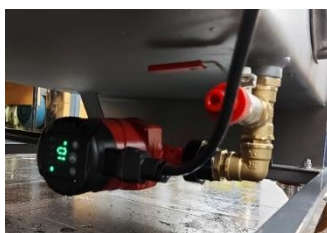
Rys. 4. Widok pompy obiegowej
