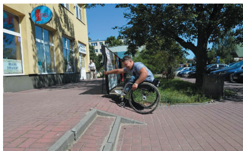
Rys. 4. Przykład nieprawidłowości stosowania urządzeń dla osób ze szczególnymi potrzebami – zbyt duże pochylenie pochylni Źródło: [41]
