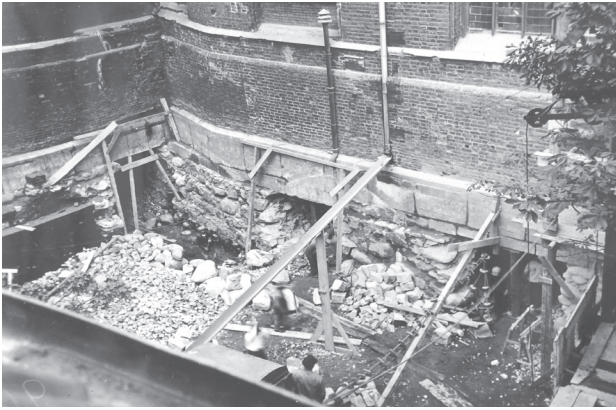
Il. 7. Rozbiórka piwnic z XVI w. w celu budowy kotłowni w 1929 r. Na ścianie nawy północnej widoczny zarys skutych koleb piwnicy (z zasobu Archiwum Państwowego w Gdańsku, [15])
