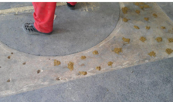
Fot. 4. Naprawa rys konstrukcyjnych i uzupełnienie ubytków po iniekcjach strukturalnych odtwarzających warstwę szczepną [M1]
