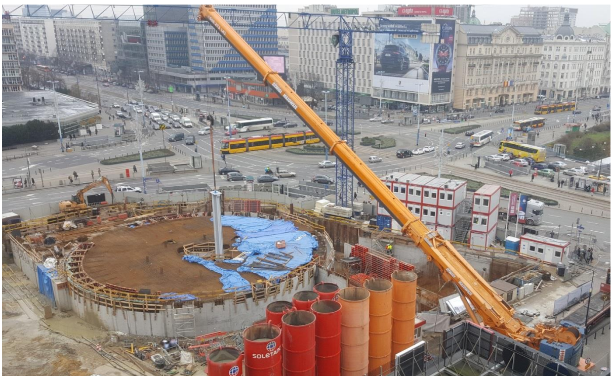
Rys. 16. Montaż słupa centralnego, który nie jest taki centralny
