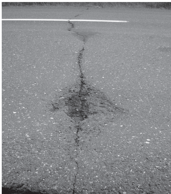
Rys.2. Przykład postępującego zniszczenia konstrukcji nawierzchni po powstaniu spękania niskotemperaturowego Fig.2. An example of proceeding deterioration of asphalt pavement after low temperature cracking has occurred
