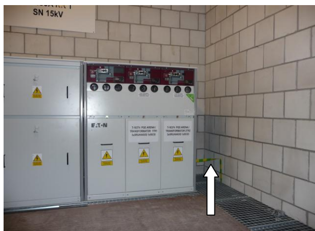
Rys. 6. Przewód uziemienia ochronnego w pomieszczeniu rozdzielnic 15 kV
