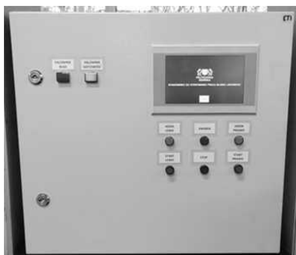
Rys. 5. Widok elewacji szafy sterowniczej
