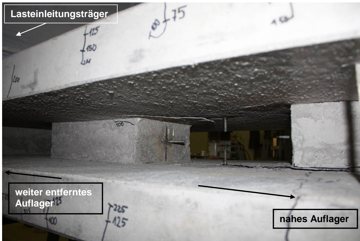
Bild 20: Risse an der eckigen Öffnung
