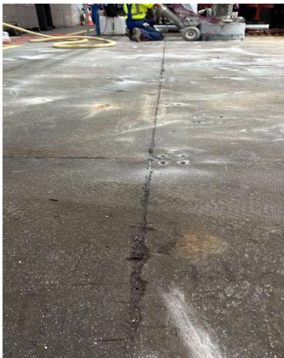
Rys. 10.1. Zdegradowana betonowa posadzka przemysłowa (Przykład 1): widoczne zużycie warstwy wierzchniej, kotwy montażowe pozostałe po demontażu urządzeń oraz uszkodzenia dylatacji skurczowej [M1]
