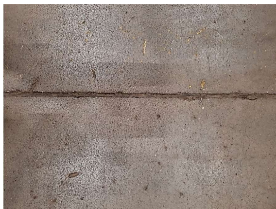
Rys. 8.7. Uszkodzenia posypki związane z zastosowaniem zbyt małej ilości utwardzacza powierzchniowego (fot. S. Świątek-Żołyńska)
