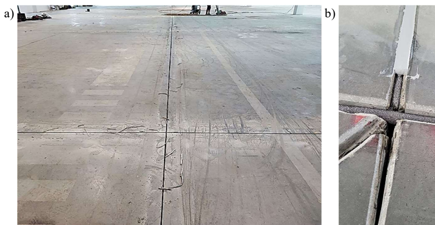
Rys. 10.17. Betonowa posadzka przemysłowa (Przykład 4) podczas naprawy: a) usuwanie zdegradowanego wypełnienia dylatacji skurczowych, b) ułożenie nowego wypełnienia dylatacji skurczowych [M1]
