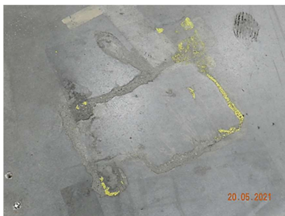
Rys. 8.6. Uszkodzenia spowodowane agresją chemiczną (fot. S. Świątek-Żołyńska)
