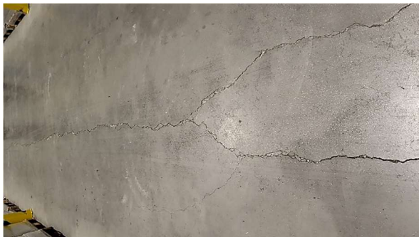
Rys. 8.14. Wysadziny w posadzce spowodowane wadliwym układem warstw podbudowy oraz awarią instalacji grzewczej (fot. S. Świątek-Żołyńska)
