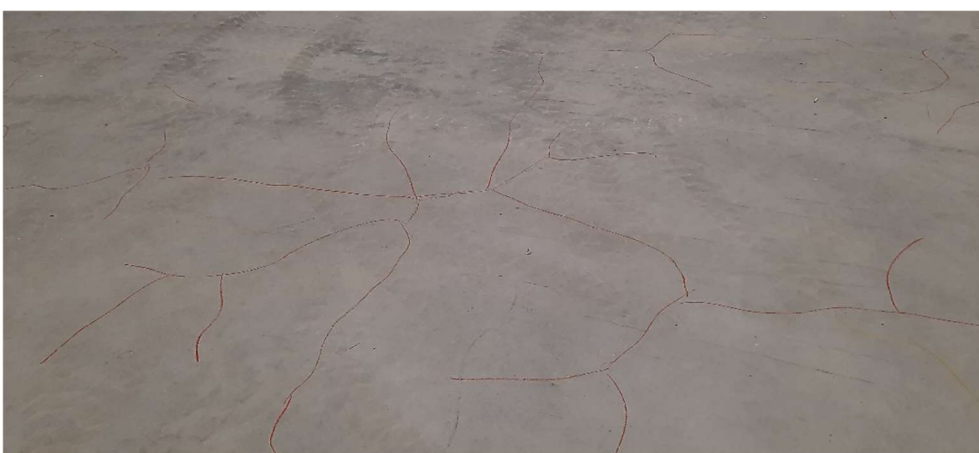
Rys. 8.13. Uszkodzenia będące następstwem braku wykonania nacięć przeciwskurczowych w płycie posadzkowej (fot. M. Niedostatkiewicz)
