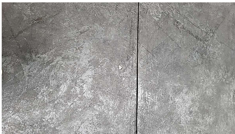
Rys. 8.9. Brak możliwości wtarcia utwardzacza ze względu na zastosowanie nadmiernej ilości popiołów lotnych w mieszance betonowej (fot. S. Świątek-Żołyńska)
