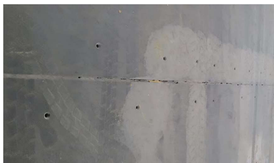
Rys. 10.14. Betonowa posadzka przemysłowa (Przykład 4) podczas naprawy: schemat nawierconych otworów do podawania iniekcji [M1]
