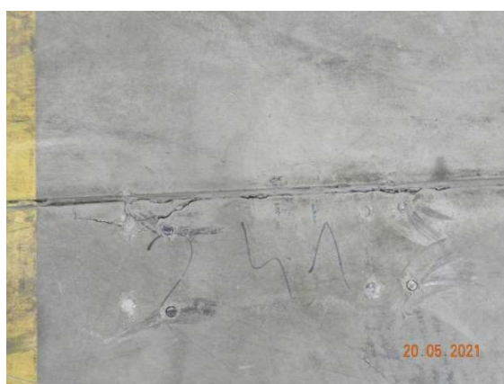
Rys. 8.5. Zniszczenia posadzki w wyniku zamontowania kotew w strefie przydylatacyjnej ( fol. S. Świątek-Żołyńska )
