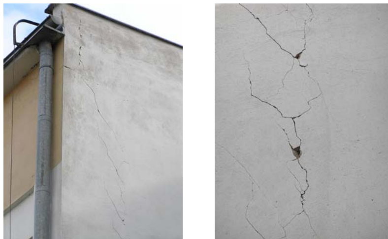
Ryc. 5. Suwałki, Szkoła Podstawowa nr 10, ul. Antoniewicza, pęknięcia tynku na ścianie szczytowej
