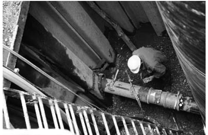
Rys. 6. Montaż lekkiej studzienki (TEGRA, WAVIN) w tradycyjnej technologii w warunkach rozmytego podłoża
