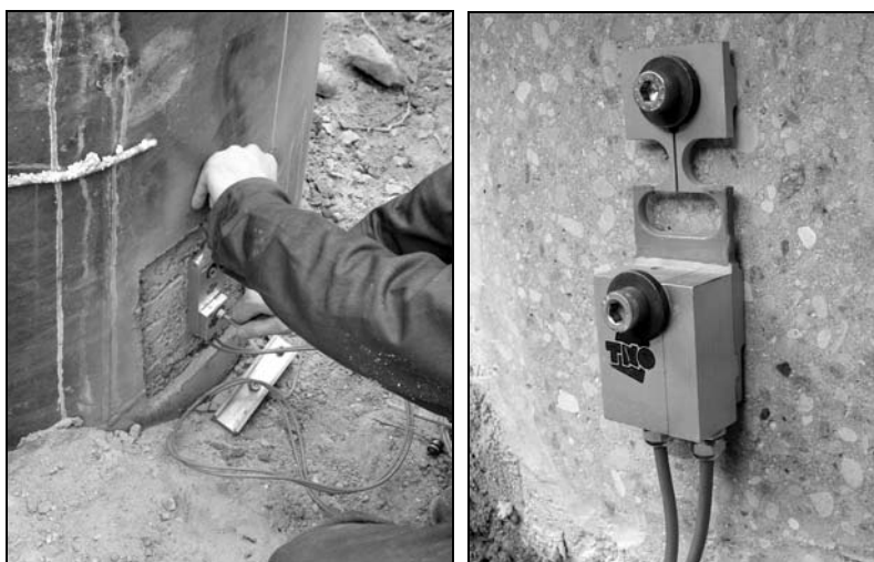
Rys. 4. Czujniki zamontowane na palu
