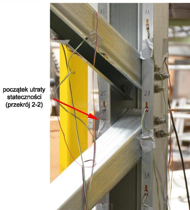
Rys. 5.20. Początek utraty stateczności przekroju kapeluszowego (na przykładzie modelu nr 4 dla wartości obciążenia P=5 kN, H_{\text{odp}}=95 kN).
