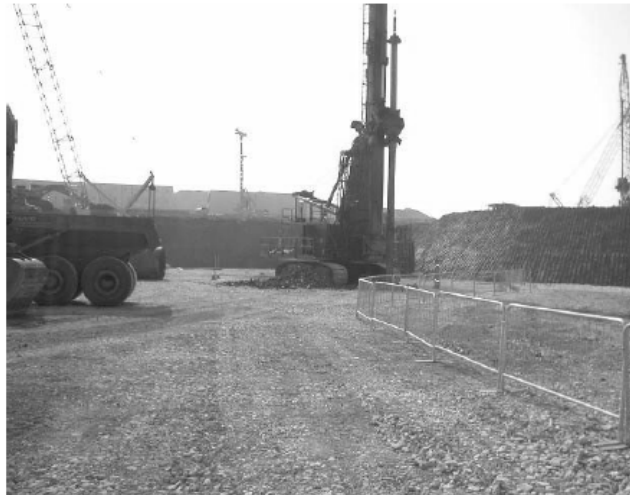
Rys. 6. Prawidłowe zabezpieczenie terenu budowy – niemożliwy wstęp (właściwe ogrodzenie) na niedokończony obszar platformy [4]
